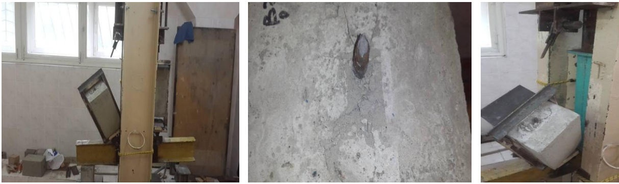
Рисунок 2 – Разрушение вследствие разрыва арматуры при выдергивании в образце АН-V-300-13
