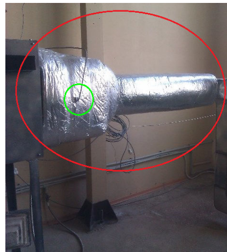
Рисунок 2 – Система оросительного охлаждения генераторного газа, вид справа: красным цветом обведен исследуемый участок газоотводящей трубы; зеленым – место установки форсунки
