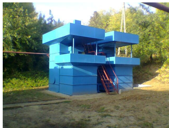
Рисунок 1 – Споруди (два блоки БІОСОФ) глибокої очистки 150 м 3 /добу побутових стічних вод
